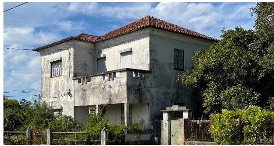
Figura 36. Manchas e bolores na fachada
