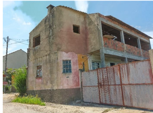
Figura 41. Edifício sem caixilharia
