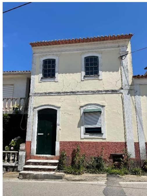
Figura 37. Fachada com fissuras
