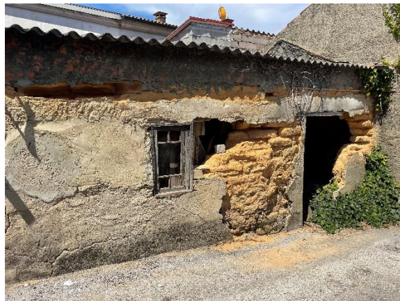
Figura 38. Desagregação de argamassa
