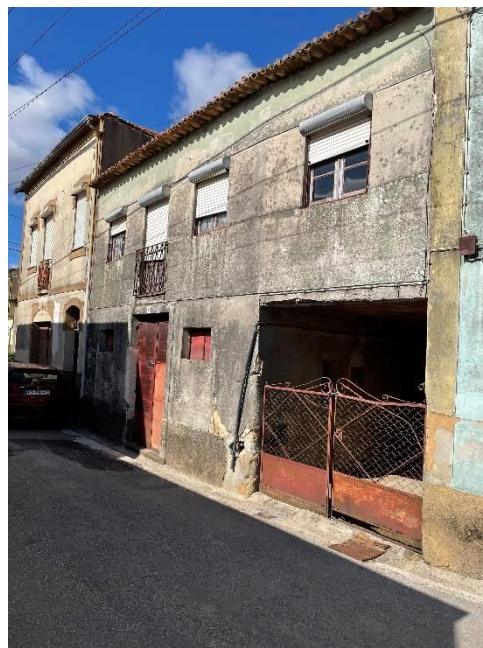
Figura 41. Manchas e bolores na fachada
