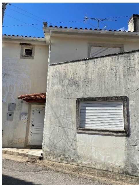
Figura 42. Fachada com fissuras
