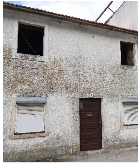
Figura 47. Edifício parcialmente sem caixilharia
