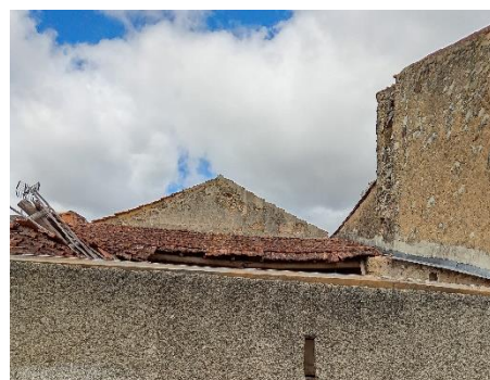
Figura 40. Cobertura parcialmente colapsada
