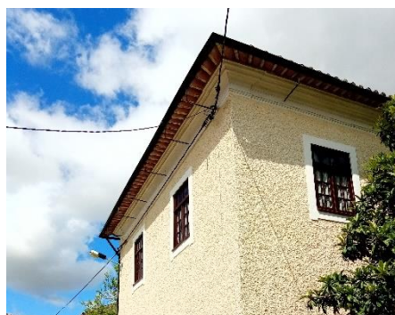
Figura 38. Cobertura com beirado e caleira
