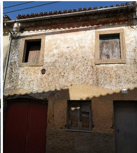
Figura 44. Fachada com deformação
