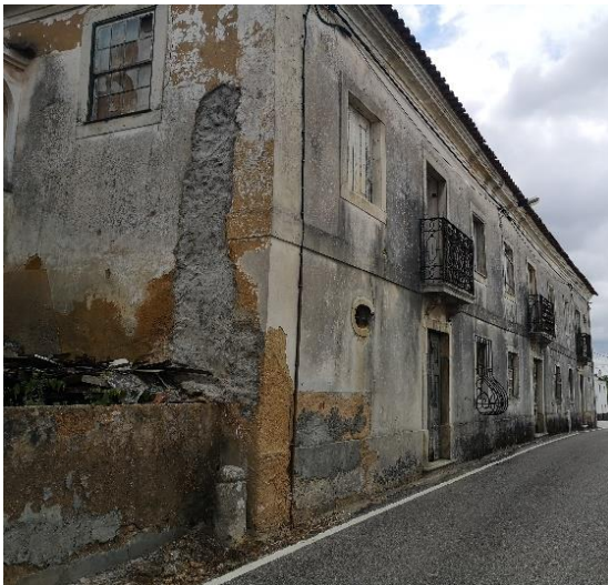
Figura 43. Desagregação de argamassa
