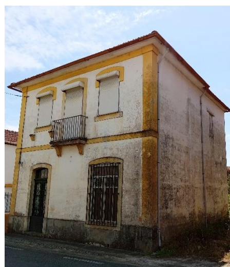
Figura 44. Manchas e bolores na fachada
