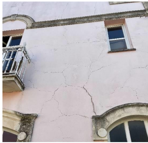
Figura 45. Fachada com fissuras
