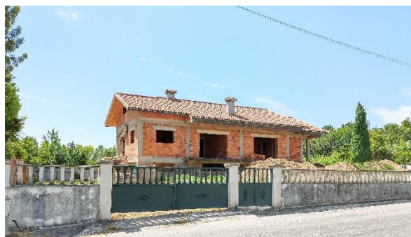
Figura 49. Edifício sem caixilharia
