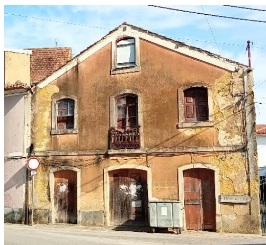
Figura 46. Desagregação de reboco
