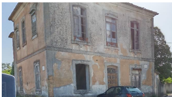
Figura 54. Edifício parcialmente sem caixilharia
