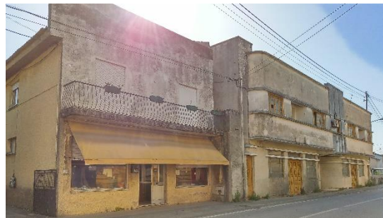
Figura 49. Manchas e bolores na fachada
