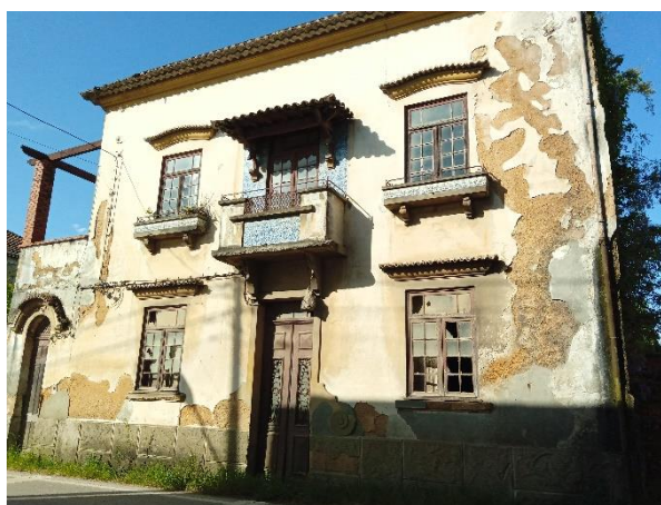
Figura 51. Desagregação de argamassas
