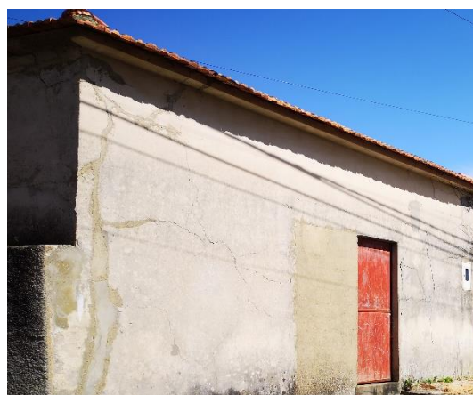
Figura 50. Fachada com fissuras
