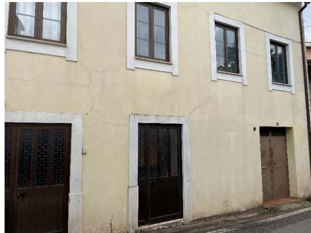
Figura 39. Fachada com fissuras
