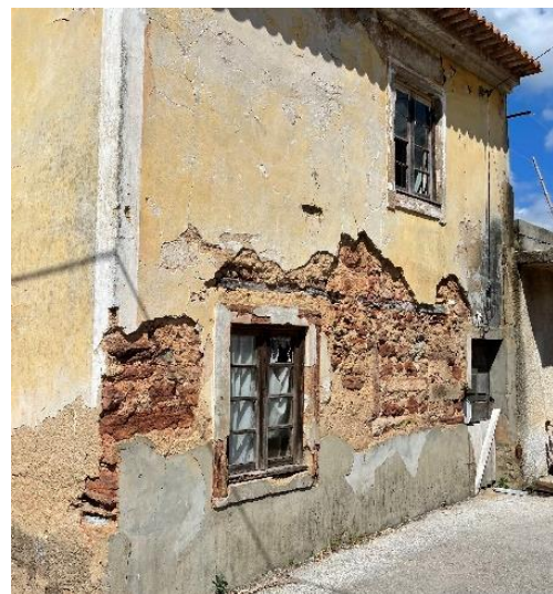
Figura 40. Desagregação da argamassa
