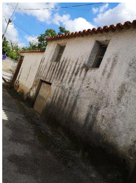
Figura 38. Manchas e bolores na fachada
